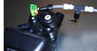
... AL TUBO DE ENTRADA Y RESTABLECIMIENTO SALMUERA
